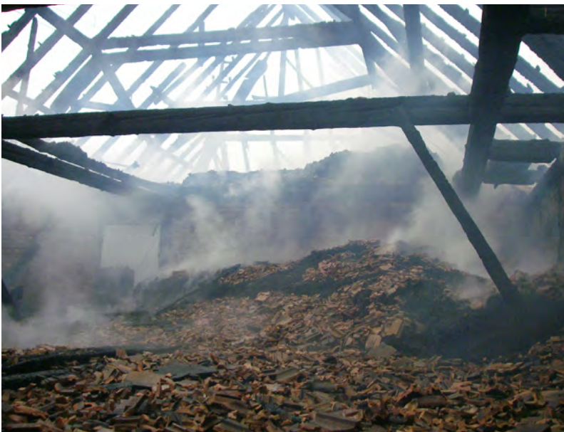
Abbildung 13: Abgestürzte Ziegel nach einem Dachstuhlbrand
